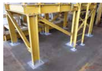
Boulons de fixation d'un pont enduits
